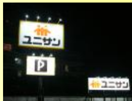
LED看板照明 LEDスクエアライト 90度拡散タイプ 合計12台設置
